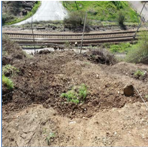
Figura 17. Deslizamiento en el Rebollu. Año 2013
